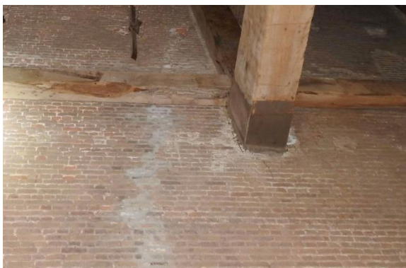
Figuur 10: Bij restauratie werkzaamheden verloren gegane wegkruipplekken, dichtgezette scheur en dichtgezet balkgat.
