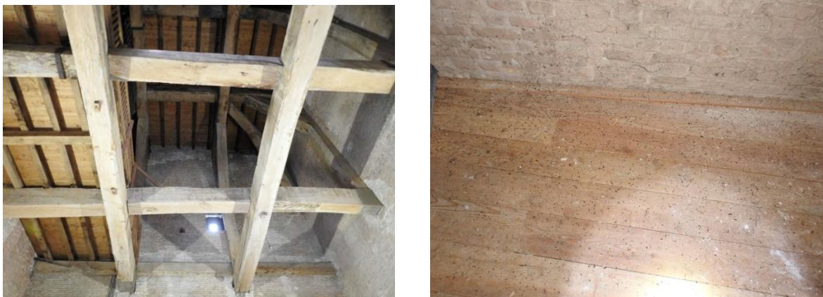
Figuur 9: De balkgaten en balken langs de wand, belangrijke vleermuisplekken, gezien vele keutels op de vloer in de toren.
