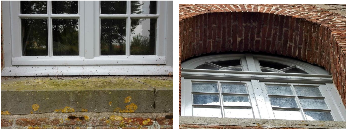
Figuur 13: Ook de ruimten naast en boven raamkozijnen worden gebruikt als wegkruiplekken en mogelijk invliegplekken.
