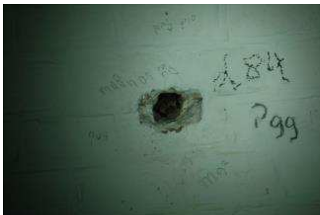
Figuur 87: Gat door Verwijdering van hang-oog en houten plug, zeer in trek bij vleermuizen
