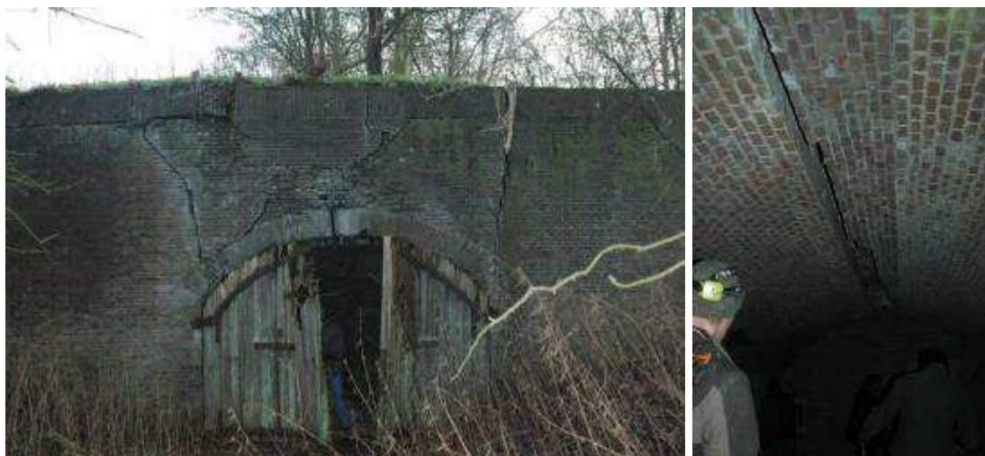
Figuur 99: Remise R7: Instabiel klimaat, bouwkundig gevaarlijk. Ook door predatoren in gebruik als slaapplek.
