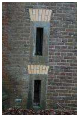
Figuur 72: Ontbrekende marterwering.
