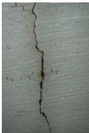
Figuur 86: Een verticale zettingsscheur, van grote waarde.
