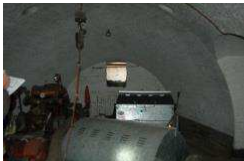
Figuur 57: Schimmelende en diesel-lekkende opslag
