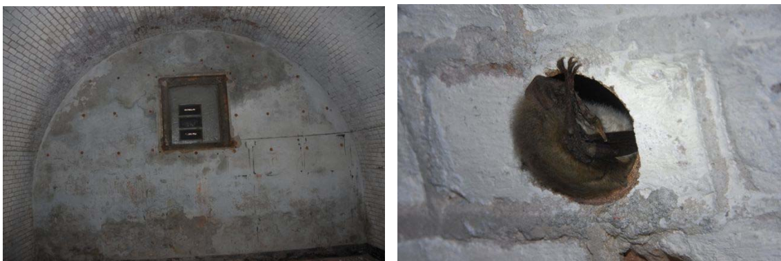
Figuur 10: Vleermuistoegang en diverse boorgaten in "invul" metselwerk, met de voor vleermuizen belangrijke condensatie boven de toegang. Rechts een van de vleermuizen in de boorgaten.
