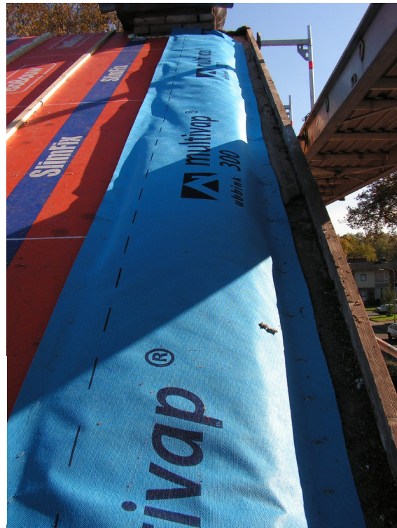
Figuur 1. Bij de uit te voeren dakisolatie wordt de spouwmuur van boven geheel afgesloten met glaswol en kunststof (zie foto). Wanneer de spouwmuur toegankelijk was via de vorstpannen zal dit na uitvoering van het grootonderhoud niet meer mogelijk zijn.
