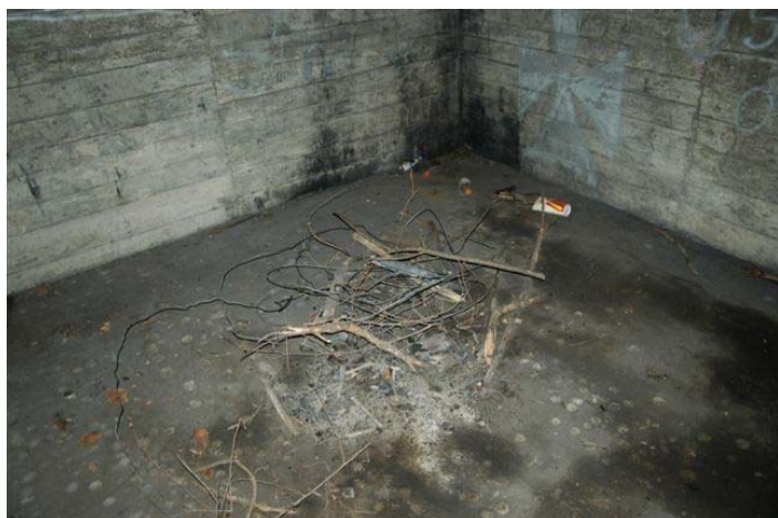
Figuur 7: Sporen van vandalisme in de groepsschuilplaats langs de Nieuwe Zuiderlingerdijk.
