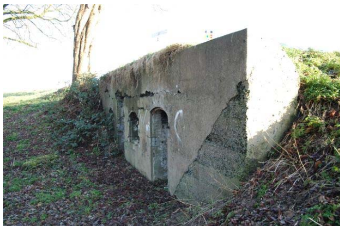
Figuur 6: Sporen van vandalisme rond de remise bij de Meerdijk.
