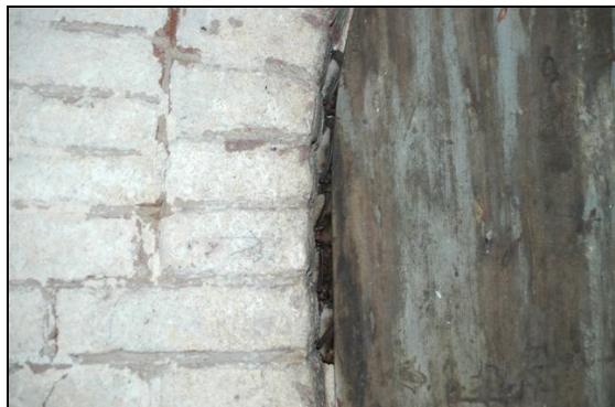
Vleermuizen weggekropen tussen deur en “kozijn” (Fort Everdingen).
