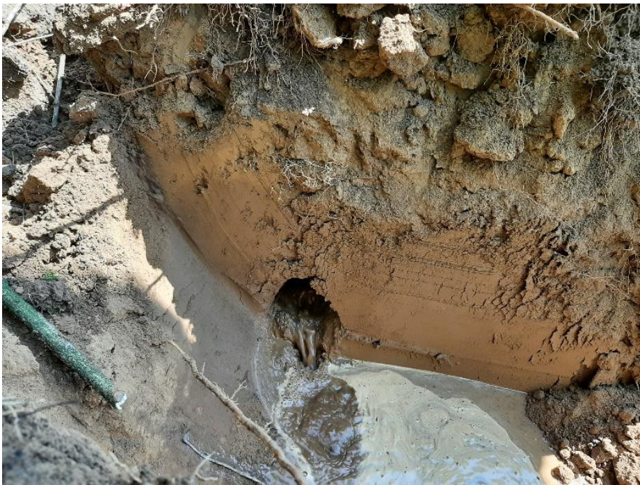
Figuur 4. Alarm aan de Lommerstraat! Rivierkwel stroomt door een dassenhol.
