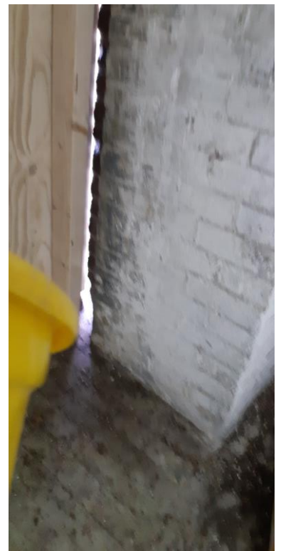
Figuur 1: Spleet tussen wand en deur bij gebouw G
