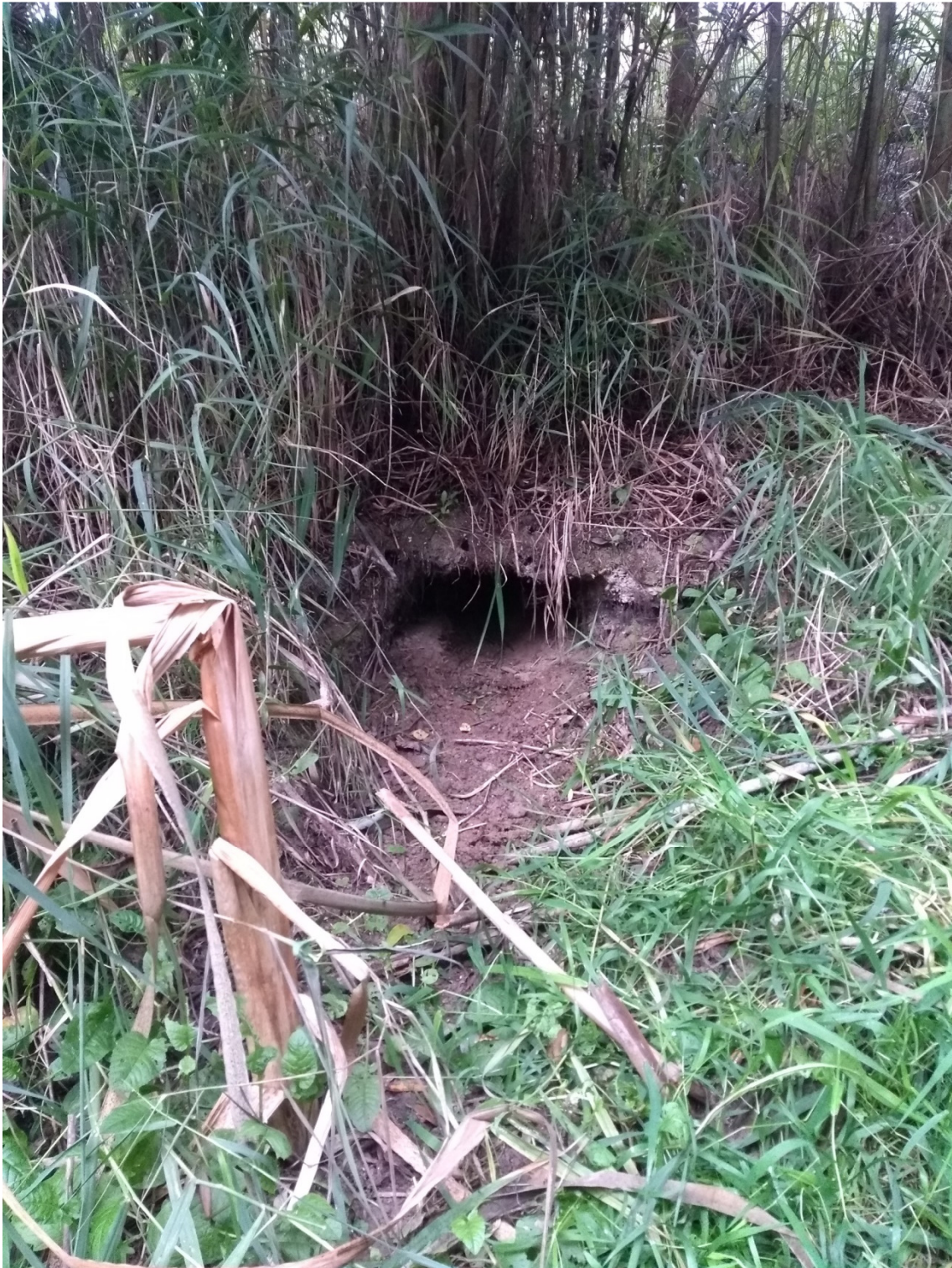
Figuur 8. De ingang van een beverhol in een drooggevalen poel, binnendijks van de primaire waterkering langs het Oude Maasje ten westen van Waalwijk.
