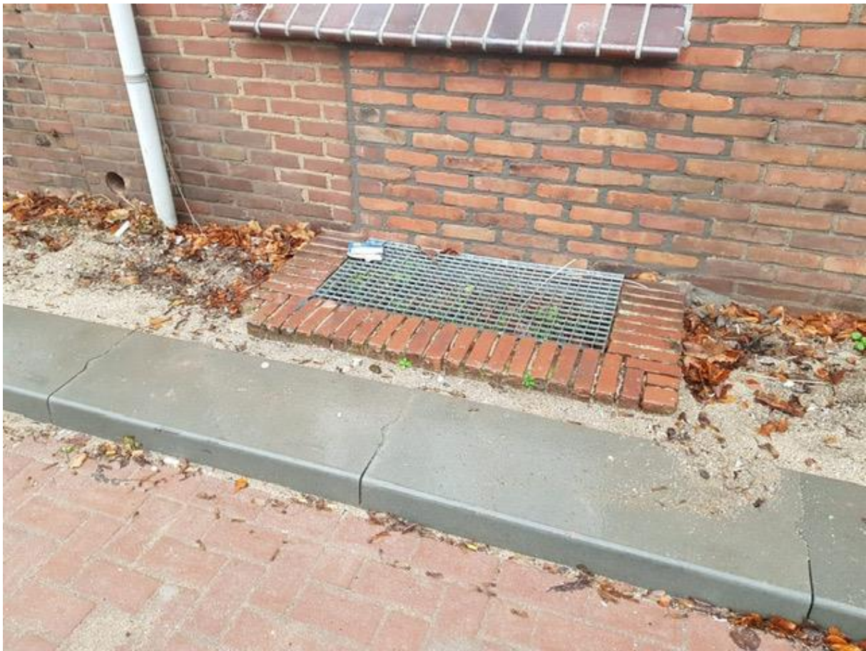
Figuur 16. Links naast de regenpijp is het gat in de muur zichtbaar waar de steenmarter naar binnen kan.
