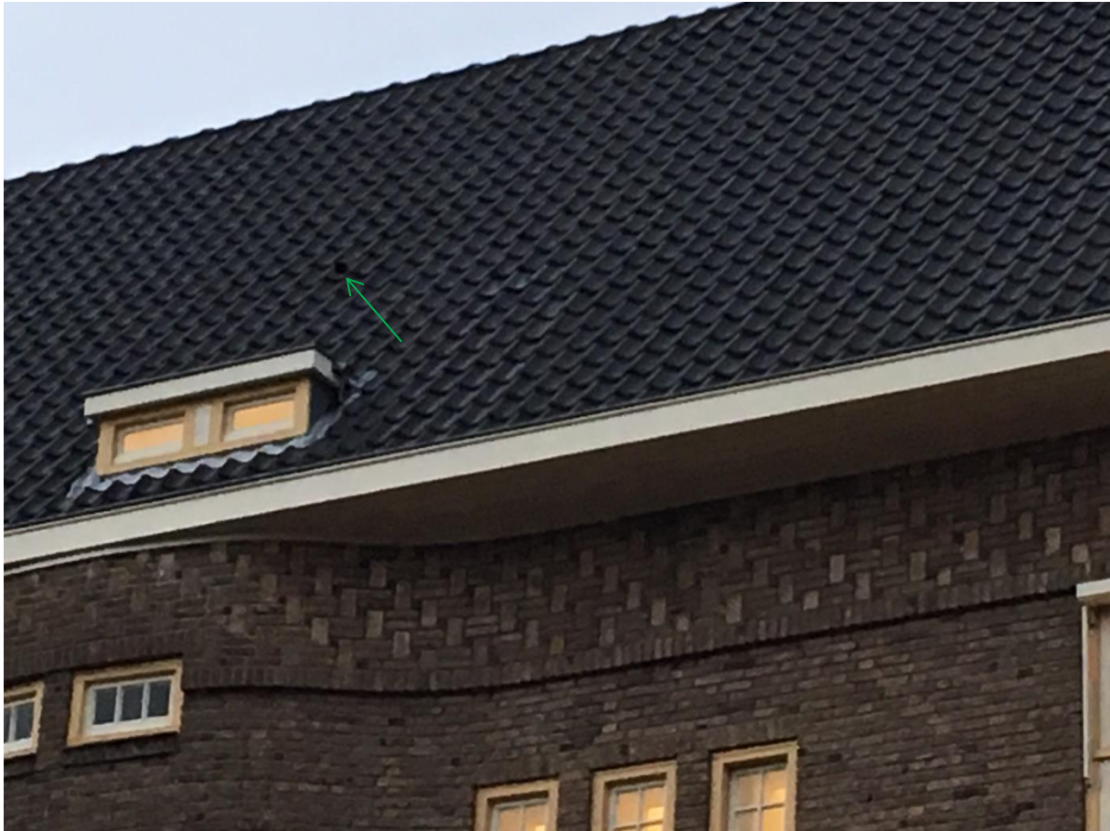
Figuur 22. Aan de zijde van de Houtlaan is een ventilatiepan aangebracht. Vleermuizen hebben hierdoor een toegang tot de zolder.
