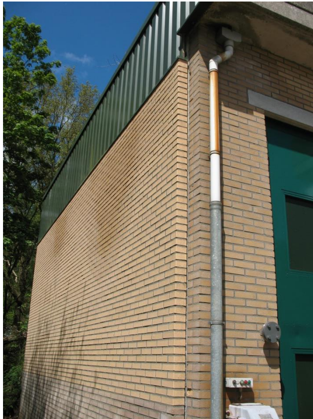
Figuur 2: Gebouw 267 na de aanpassingen (goed te zien is dat bij de stootvoegen de vochtigheidsgraad hoger is). Detailfoto geeft de open stootvoegen weer.
