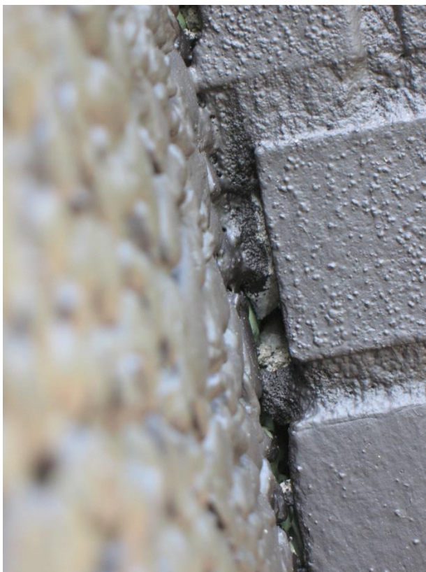
Figuur 5: Detail van achterzijde. De spouw lijkt niet helemaal dicht te zijn aan de zijkant.
