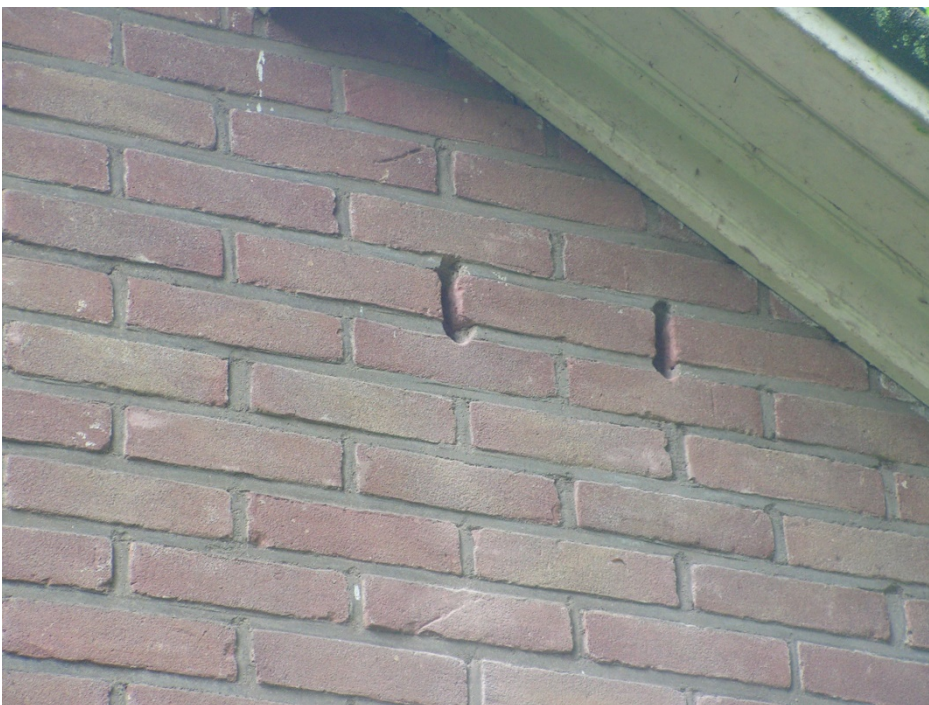
Figuur 6: Voorbeeld van open gemaakte stootvoegen bij gebouw 125
