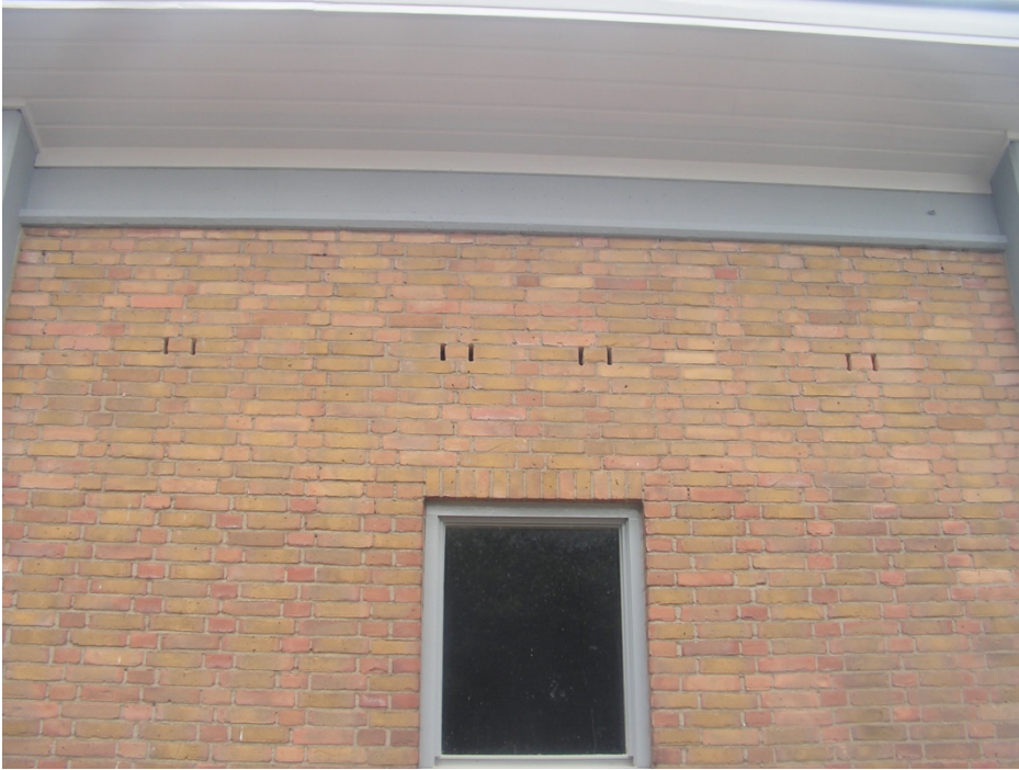
Figuur 3: Voorbeeld van open gemaakte stootvoegen bij gebouw 130
