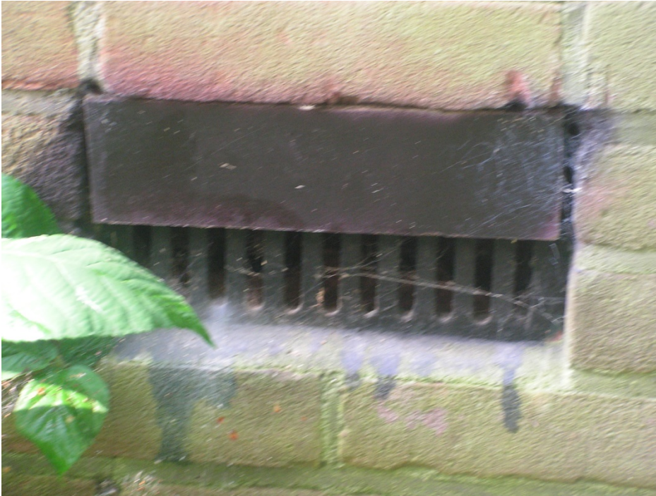
Figuur 7: Voorbeeld van half dichtgemaakte stootvoegen bij de grond bij gebouw 125
