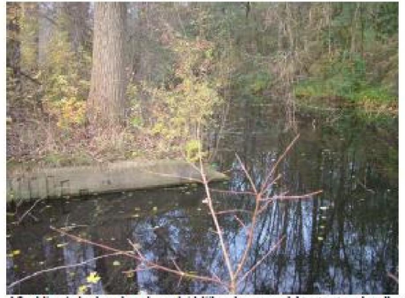
Afbeelding 4, de vleugelwand, een duidelijk andere oppervlakte structuur dan alle andere NHW objecten langs het Lekkanaal
