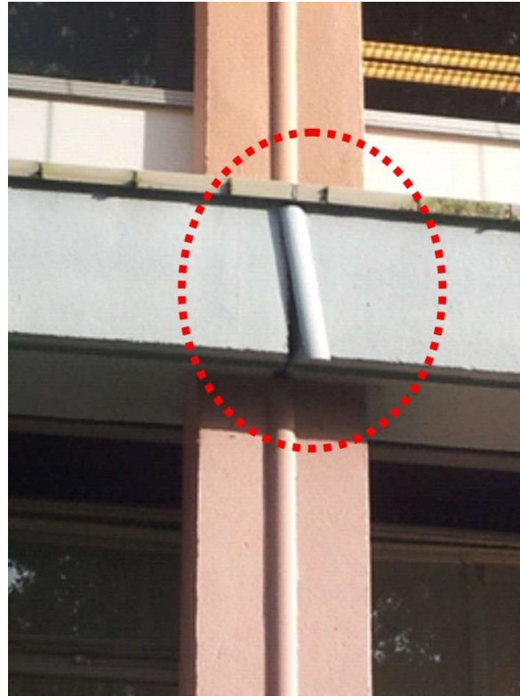
Figuur 6: Aan de achterzijde is de afdekplaat van de dilatatievoeg van Comeniuslaan 4 verschoven en is er een - toegang tot - verblijfsplek. Dit is de waarschijnlijke verblijfplaats van gewone dwergvleermuizen.
