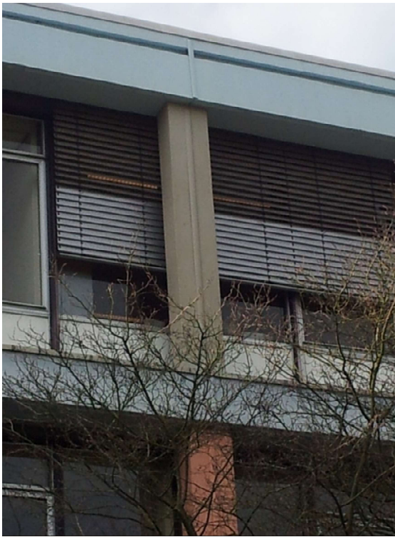
Figuur 5: De dilatatie middenin het gebouw Comeniuslaan 4, voorzijde en achterzijde.
