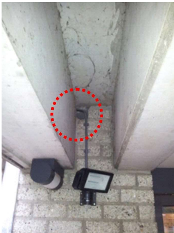
Figuur 4: Een ruim doorvoergat voor leidingen in metselwerk bij de ingang van Comeniuslaan 6.
