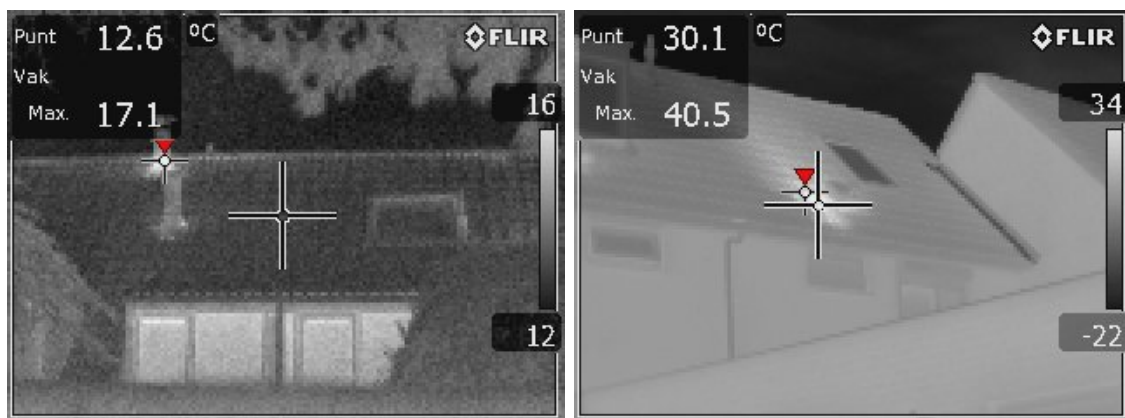
Figuur 7a: De warmere plekken rond een afvoerkanaal. Figuur 7b: Het warmtelek bij woning 723.
