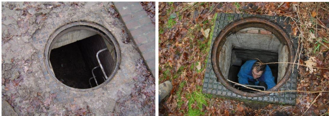
Figuur 2: Een putring met stijgbeugels als vandalismeproof inspectietoegang tot de kelder.
